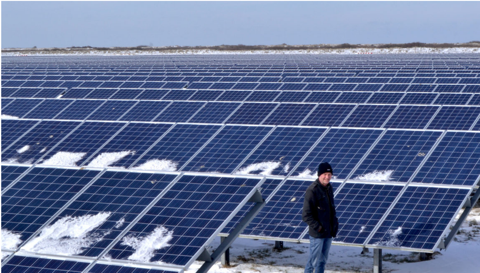
Johan Kiewiet temidden van de 23.000 panelen van Zonnepark Ameland
